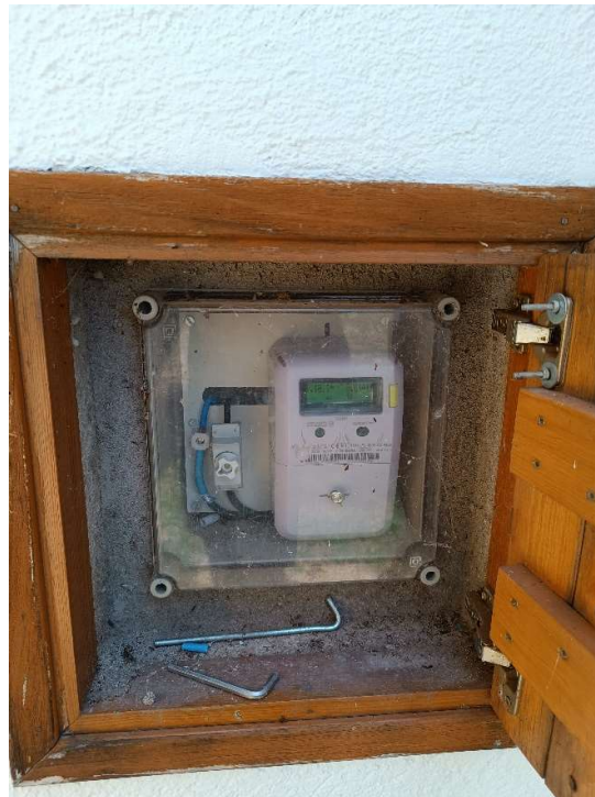
Fig. 6 Vista detall ubicació comptador de consum actual.
