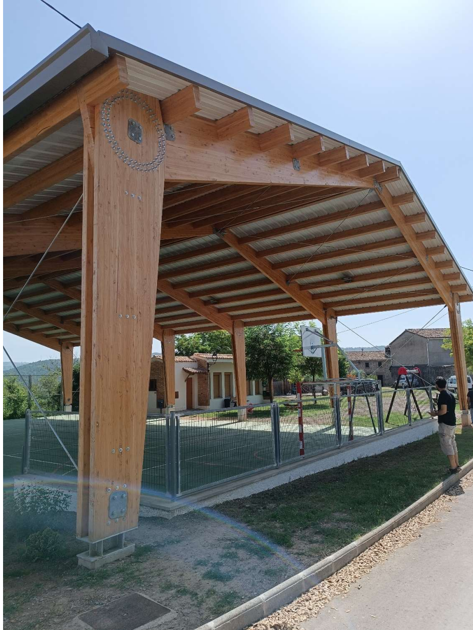
Fig. 4 Vista detall ubicació inversor. Zona on s'hi ubicarà l'armari amb inversor.
