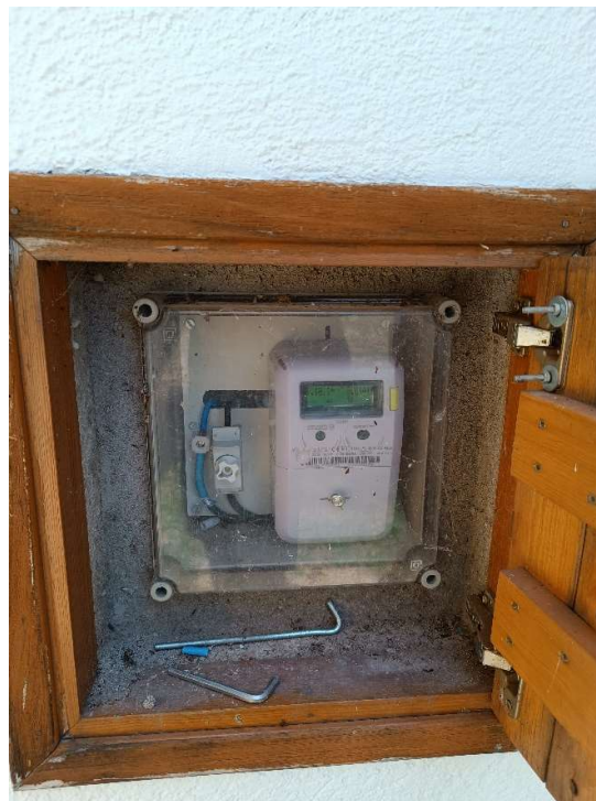
Fig. 6 Vista detall ubicació comptador de consum actual.
